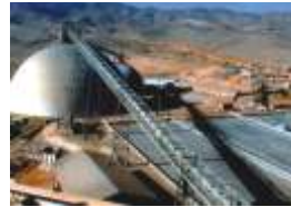
TRANSPORTADOR DE CLINKER/CIMENTO
